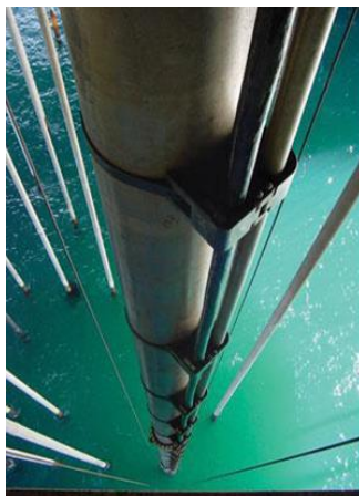
Figure 13 – Une partie de riser non immergée [21].
