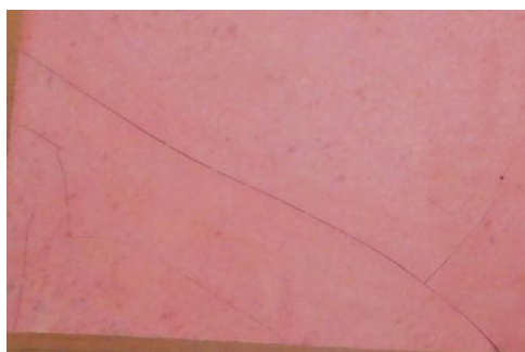
Présence de fissures pré-incendie (Matrice)
