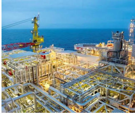
Figure 5 – Unité de traitement d'eau (Image Suez Environnement – Degrémont).
